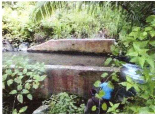
Gambar 3.1. Kondisi Intake & Bangunan Bak Pengumpul Mata Air Wae Moto
