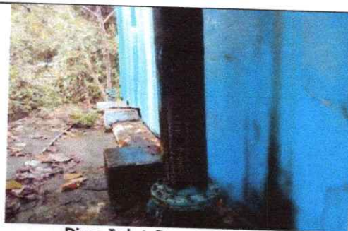
Pipa Inlet Resvr. Golo Koe
